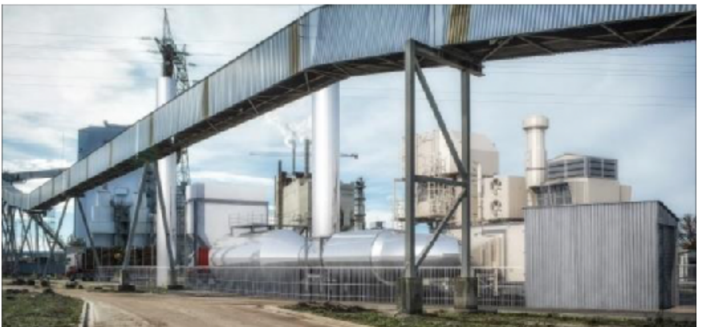
Situation après l'installation de l'unité de cogénération
